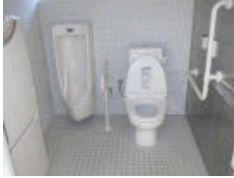
浄化槽での使用
